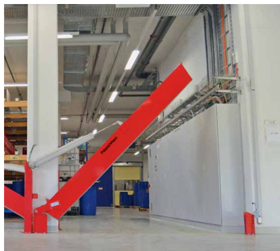
Barrières de retenue d'eau d'extinction d'incendie pneumatiques
