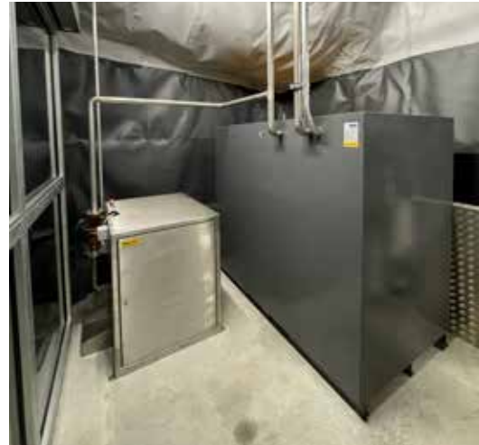
Der Zwischentank befindet sich 3000 m ü. M.
