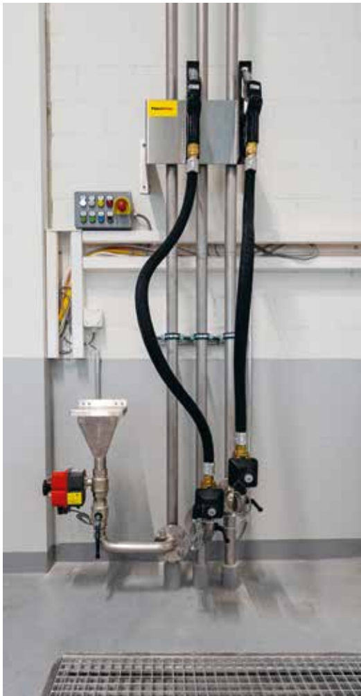
Zapfanlagen auf jeder Etage sorgen für einfaches Entnehmen des Öls. Gleichzeitig kann Altöl sicher entsorgt werden.
