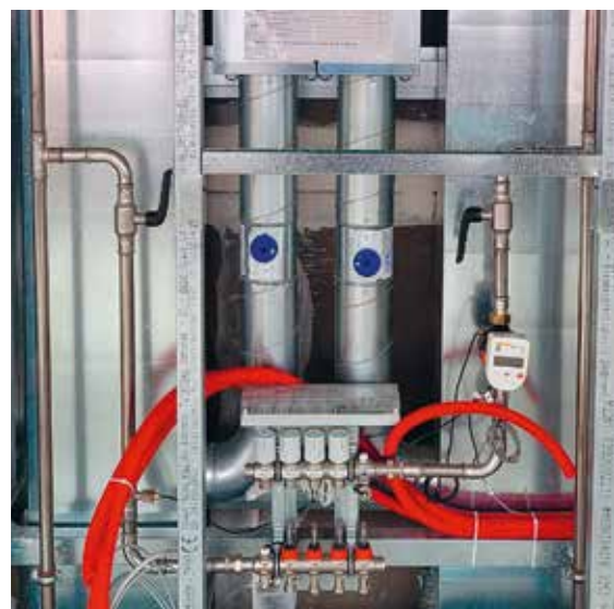
Ausgestattet wurden die Module mit NeoVac-Messgeräten.
