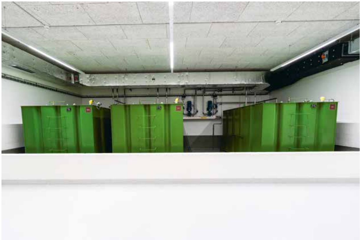
Jeweils 10'000 Liter Fassungsvermögen haben die zwei Schneidöltanks und der Altöltank im Untergeschoss.
