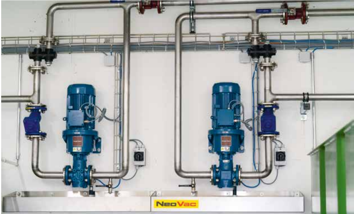
Absaug- und Füllleitungen transportieren das Schneidöl in die jeweiligen Stockwerke.
