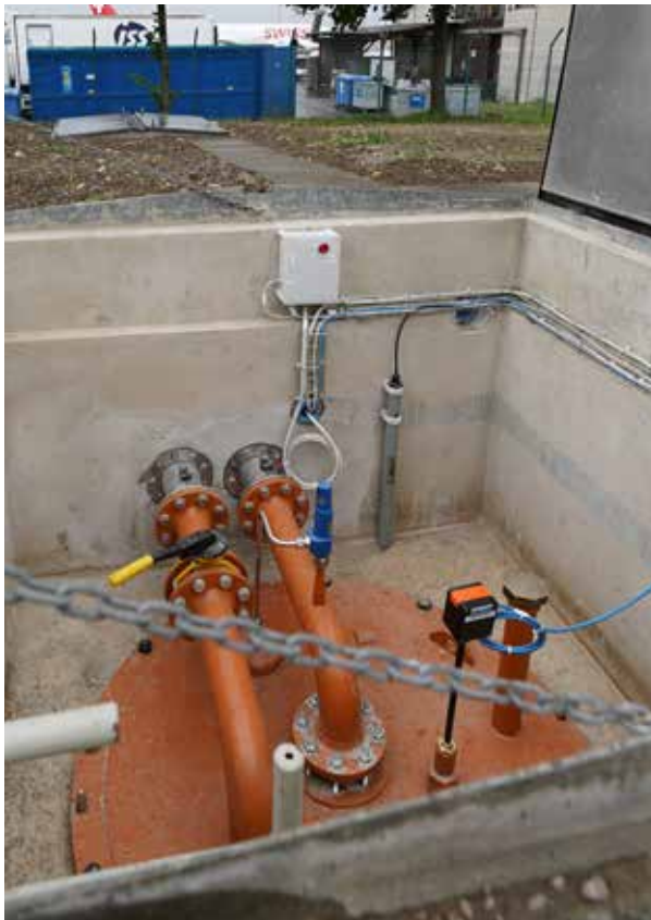
Il pozzetto valvole con diverse sonde di monitoraggio.
