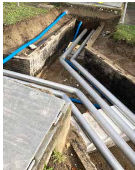
Sono stati posati complessivamente 230 metri di tubi in acciaio cromato a doppia parete.
